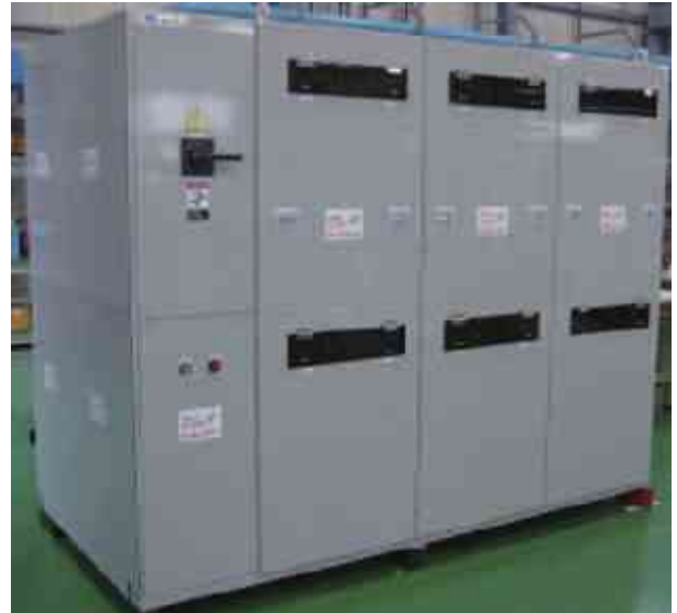
対象エリア均一加熱 IH 電源 (20kW × 複数台)
