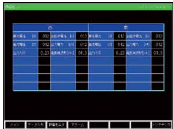
図 8 タッチパネル設備モニタ画面
